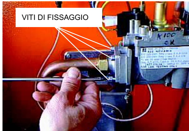
Figura 23 – Viti di fissaggio flangia gas
